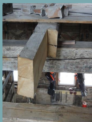
Deutlich sichtbarer Sanierungsbedarf
